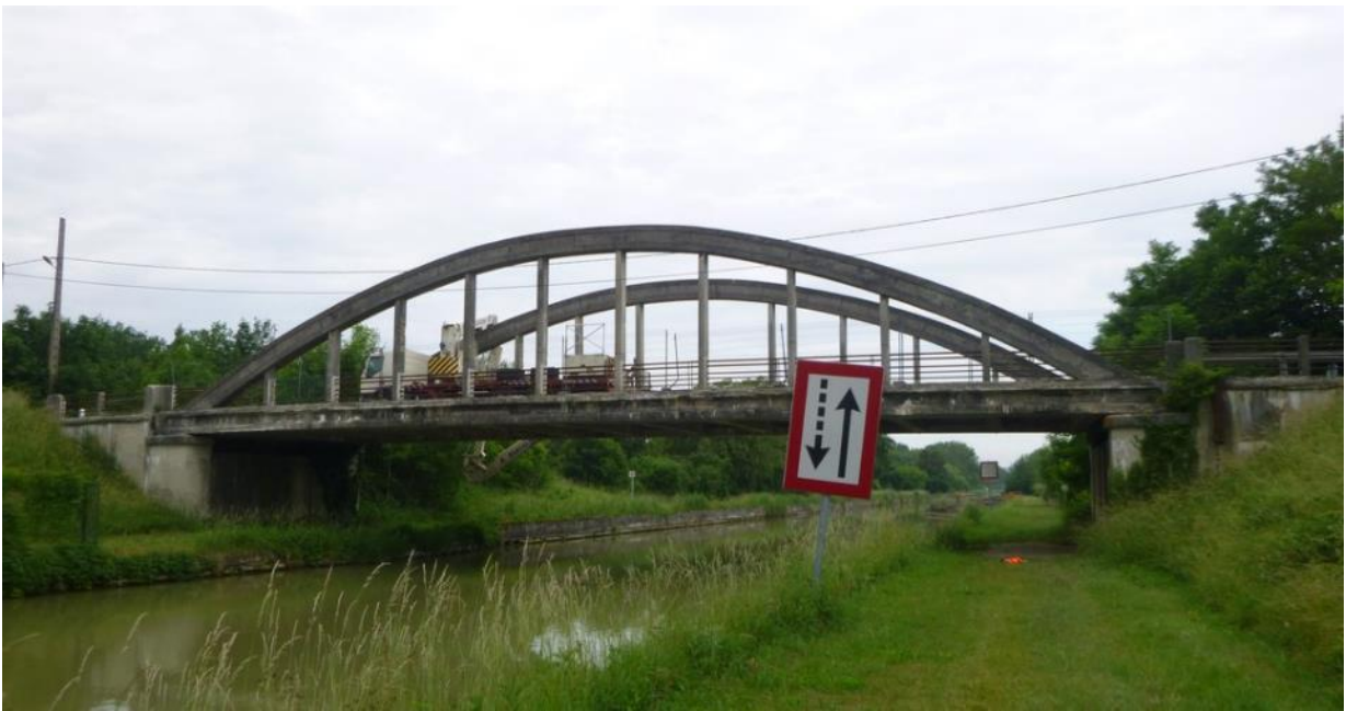
L'ouvrage d'art n°D0493 RD967 franchissant le canal de l'Oise à l'Aisne (commune de Bourg-et-Comin) avant travaux
